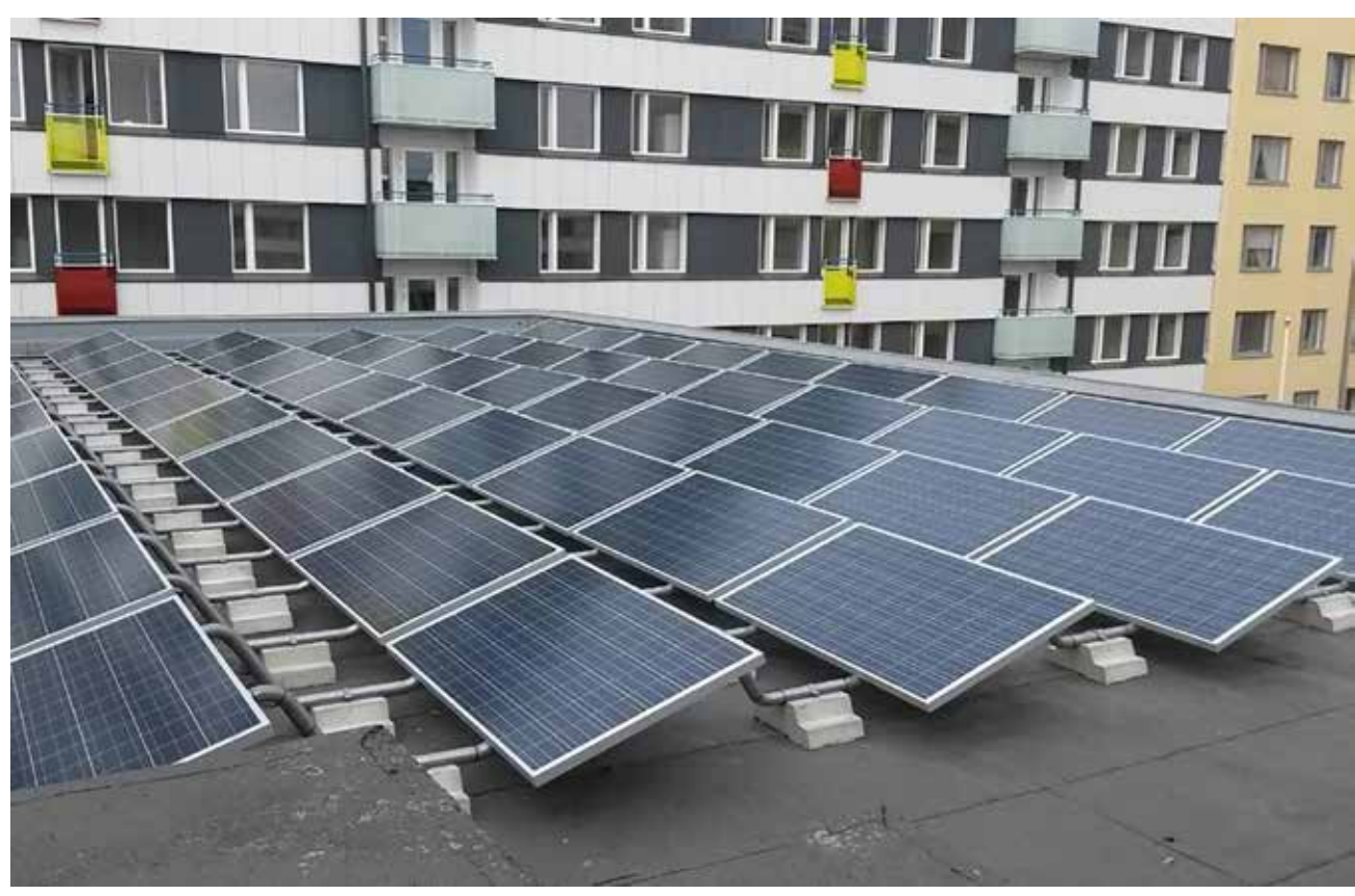
Aurinkopaneelit Tampereen Hämeenpuisto 21:n katolla. Kuva: Sähköasennus Salminen
